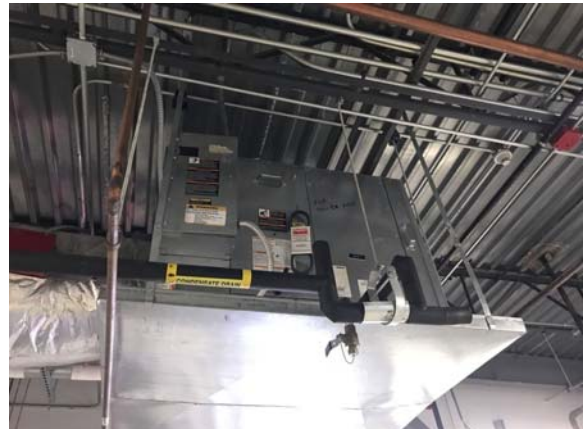
121014e 2/10/2022 Fan coil unit Penthouse
