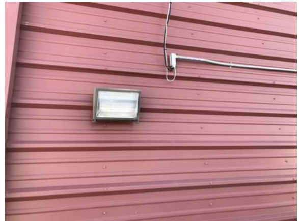
121007e 2/10/2022 HID wallpack Roof
